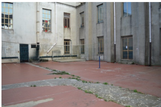
Pavimento sconnesso del cortile
