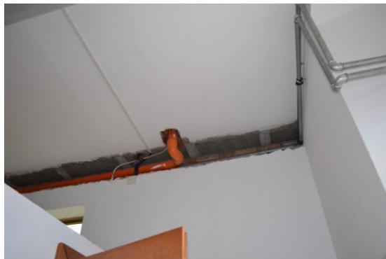
Traccia aperta tra parete e soffitto
