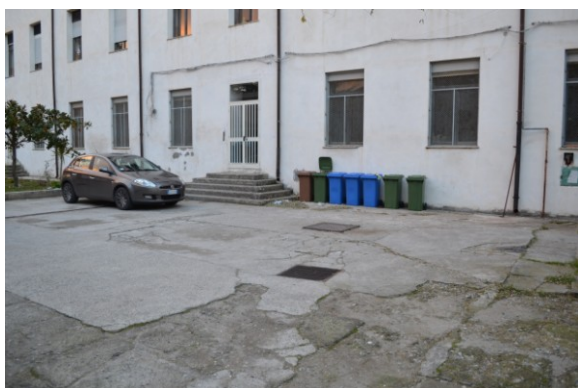
Pavimentazione sconnessa del cortile esterno
