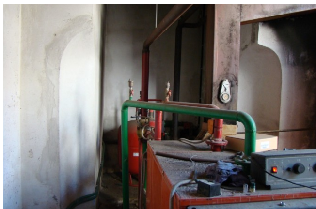
Caldaia della Scuola Elementare alimentata a gasolio
