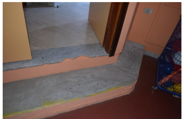
Soglia del gradino della porta di accesso alla palestra
