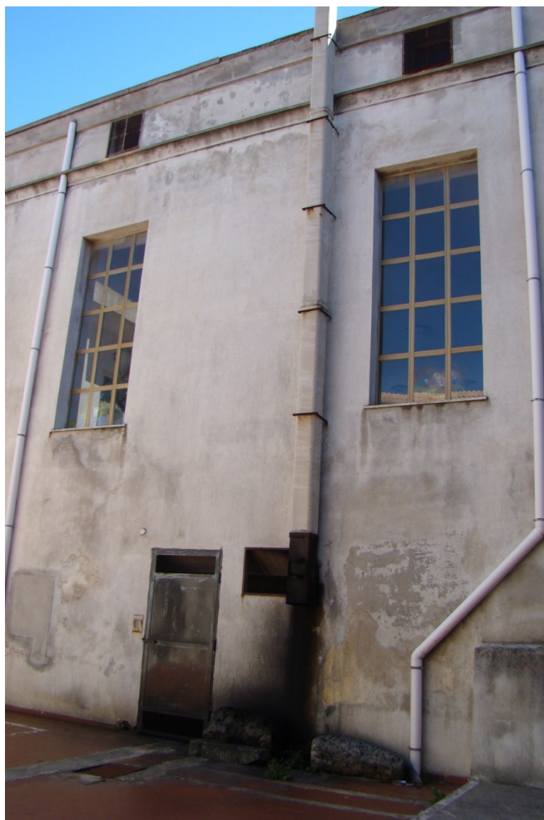
Locale caldaia Scuola Elementare e canna fumaria in eternit
