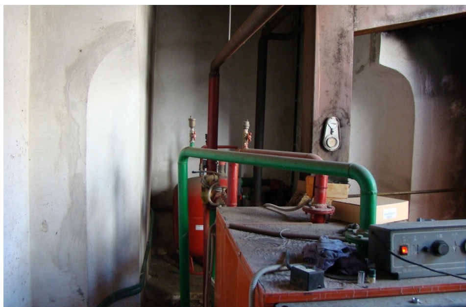
Caldaia della Scuola Elementare alimentata a gasolio
